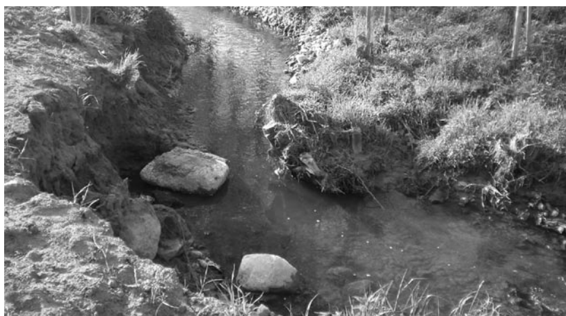
Bild 7: Herauslösung und Freispülung von Steinen und Blöcken aus der Böschung (Mai 2006)
