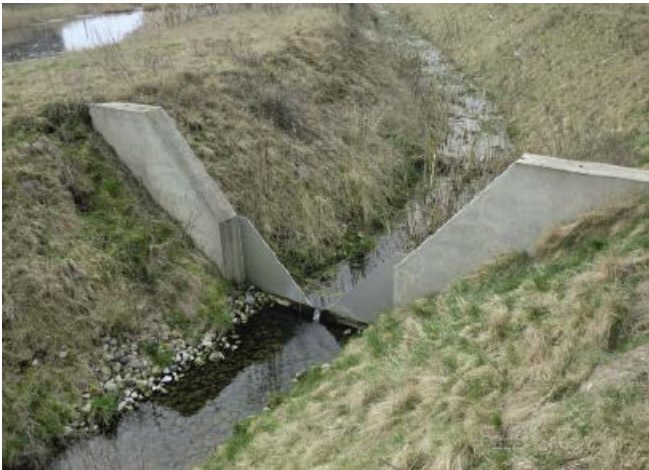
Abb. 5: Thomson-Dreiecküberfall am Einlaufgraben der Dränzuläufe
