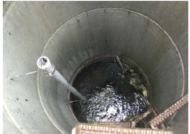
Abb. 6: Messschacht mit Drucksonde und Thomson-Dreiecküberfall (Ablauf Kläranlage)
