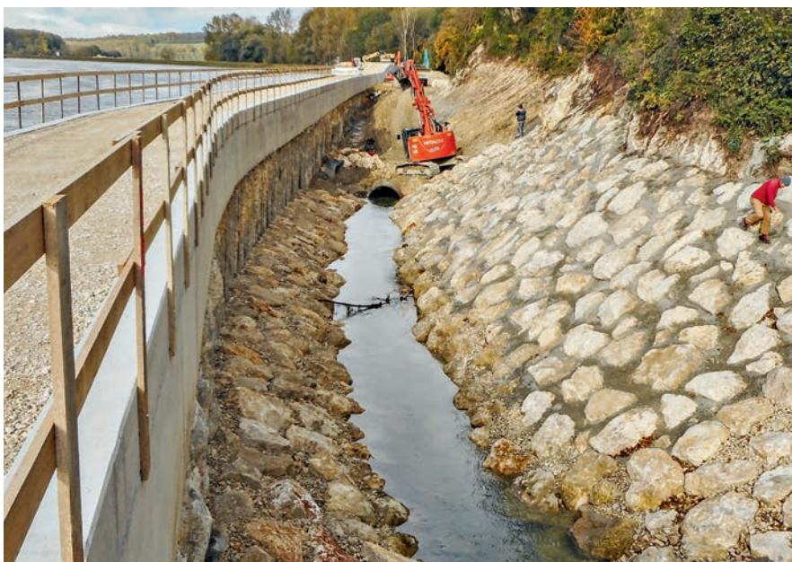
Abb. 9: Öffnung der Finkensteinverrohrung als Bestandteil der Fischauftiegsanlage.
