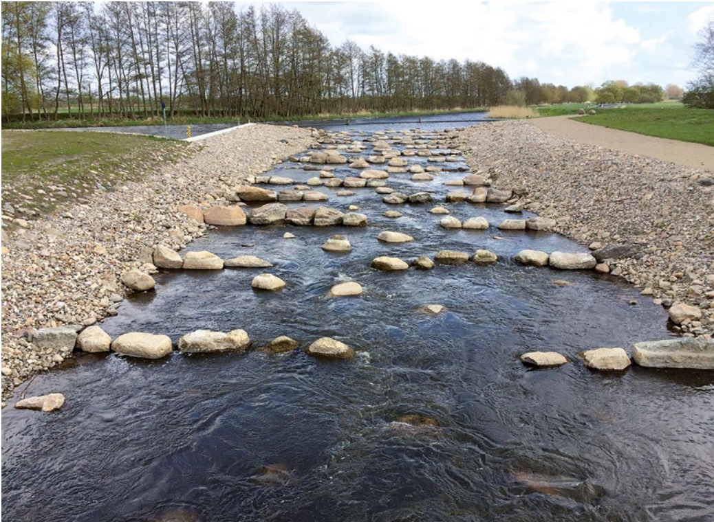
Bild 1: Ansicht der FAA Parum/Nebel, oberer Anlagenteil
